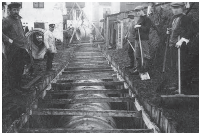
Kloakanlæg gennem gården i Låsbygade 14 til Slotssøen. 1922. Fotograf: Ukendt.
