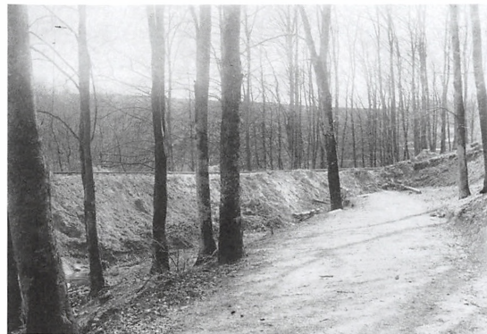
Troldhedebanen føres gennem Kolding skov. Øverste foto før anlæggelsen, det nederste fra 18. april 1915.
