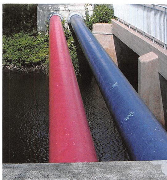
TVIS-rør fører vand ved 105° C til vekslerstationen.
