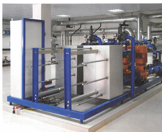
Fjernvarmeunit i boligblok i Habin i Kina.
