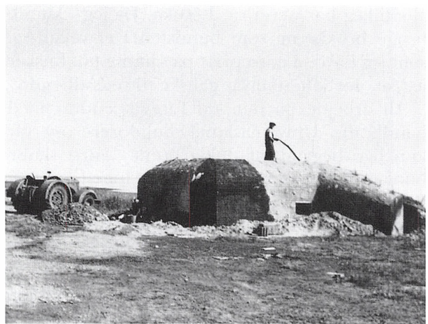
Midt i hver rum i Bunkeren var anbragt en afmålt ladning Trotyl. Efter at alle huller var tætnede, blev bunkeren fyldt med vand
